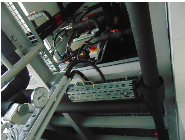
Levegő-víz hőszivattyú hydroboxok (tartószerkezet felett)
