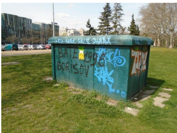
15. ábra A tervezett C építési hely közelében álló 28487/10 tr. állomás
