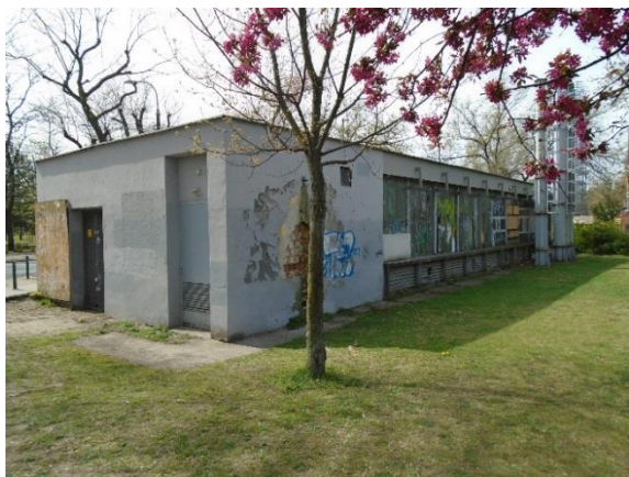
12. ábra Megszüntetésre kerülő 27501/10 tr. állomás a Petőfi Csarnok épülete mellett
